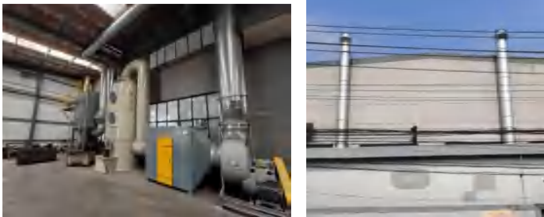
图 3-1 废气处理设备照片
