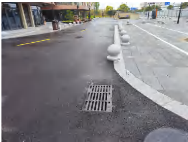
照片 1: 排水管网 (2022.09)
