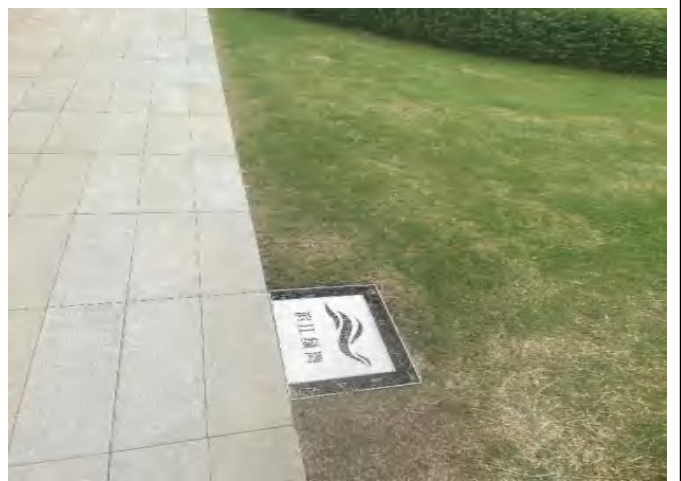
照片 6: 排水管网 (2023.7)
