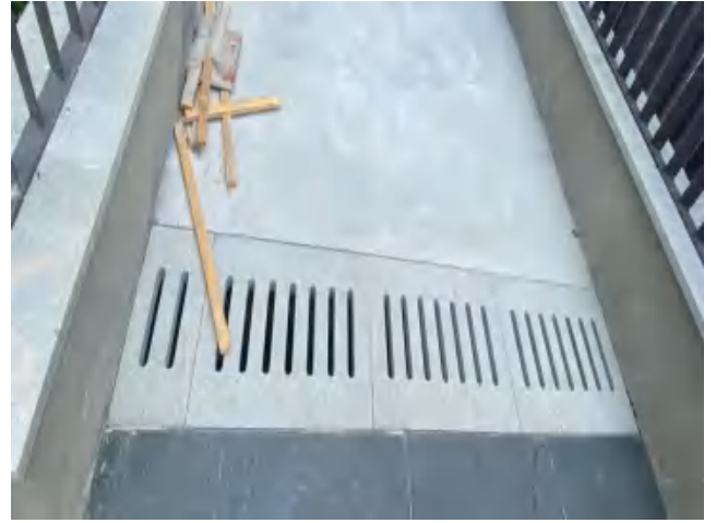
照片 2: 排水管网 (2023.3)
