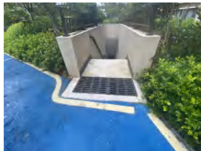
照片 6: 排水管网 (2023.6)
