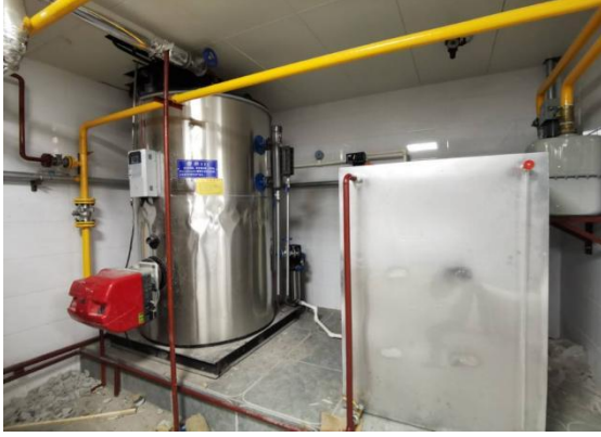
蒸汽燃气锅炉
