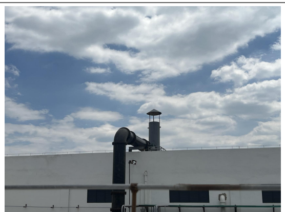
2#排气筒（结晶工段）
