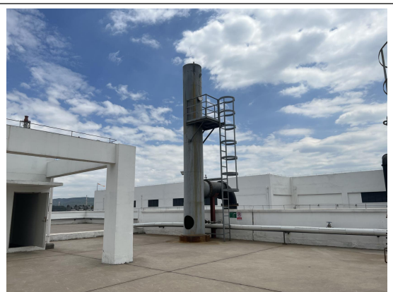
1#排气筒（制气合成工段）
