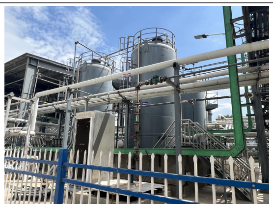
3 个氢氟酸储罐
