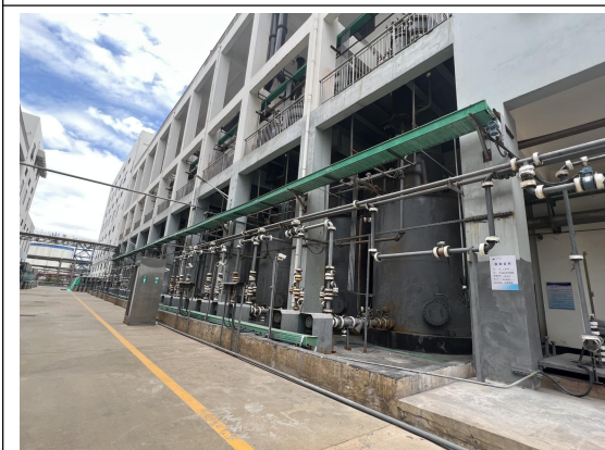
结晶工段废气吸收塔（10个）
