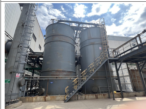
除氟盐酸槽（氯化钙工段区）
