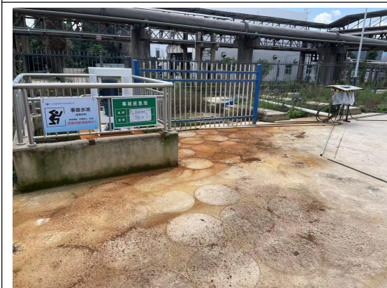
项目厂区事故应急池
